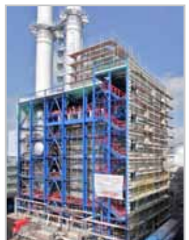
Eine Anlage in Braunschweig
