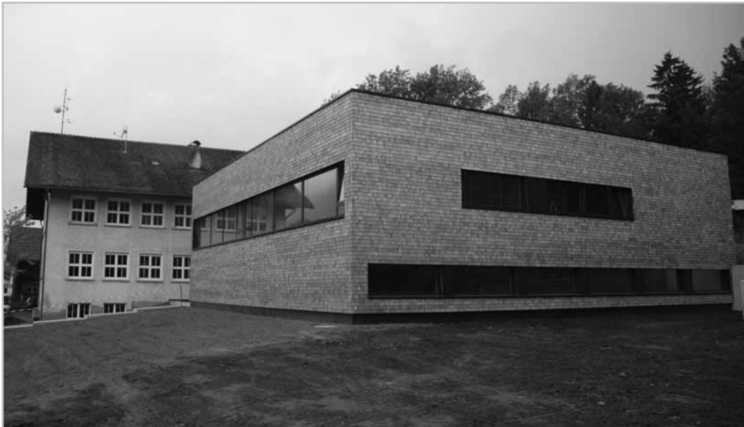
In den nächsten Monaten wird am Innenausbau des neuen Kindergartens, der Schulturnhalle und der diversen Nebenräume der Volksschule Bludenz-Braz gearbeitet.
